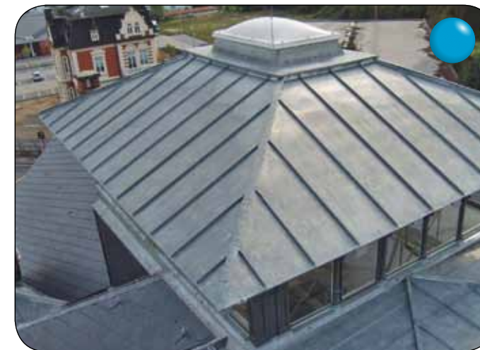
Zinkdach im Detail
