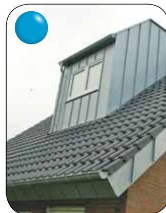
Zinkdach im Detail
